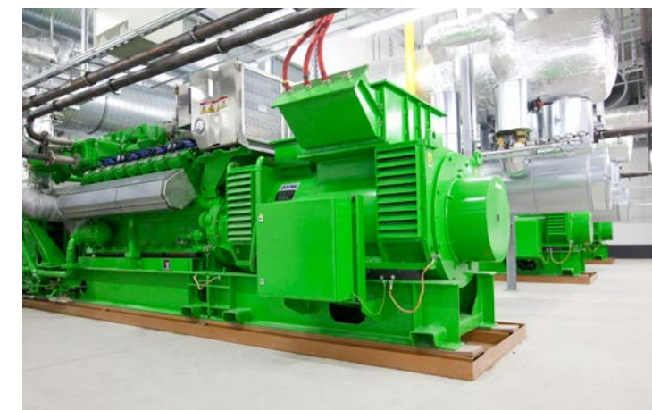
Die Blockheizkraftwerke tragen zum nachhaltigen Uniklinik-Betrieb bei.
